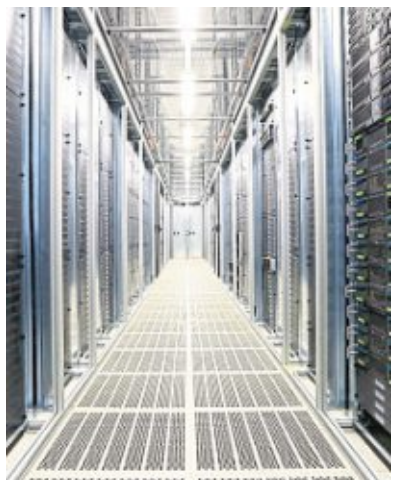
Blick in ein Rechenzentrum: In Rheinhessen ist eine sehr große Anlage dieser Art geplant.
